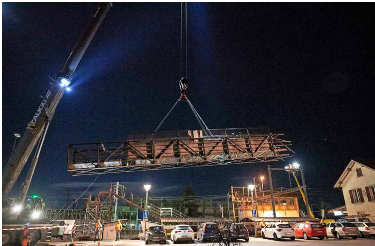
Sie wurde wegen ihrer Bauart schon der «Eiffelturm von Kerzers» genannt, nun wird die rostige Passerelle instand gesetzt.
