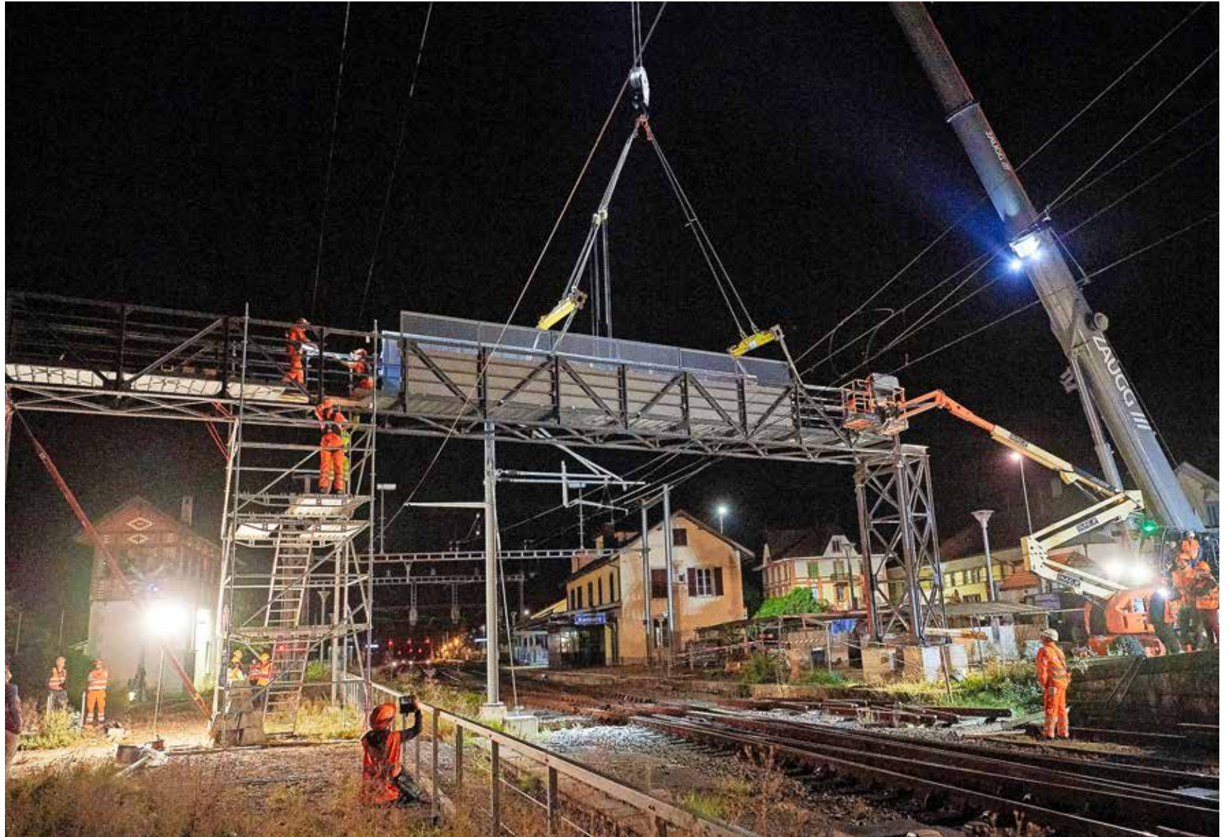
Rund 15 Personen waren in der Nacht auf Donnerstag im Einsatz, um das zweite Element der Passerelle Kerzers über den Gleisen zu montieren.
